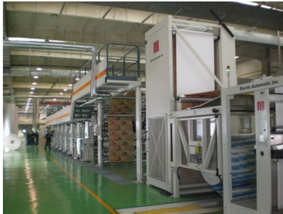
图 1：泉林公司已安装的马汀不停机放卷设备
